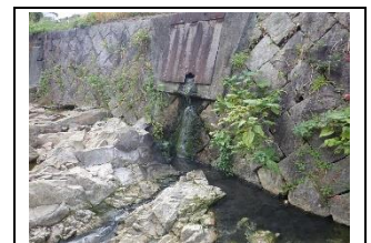
生活排水の流入状況
